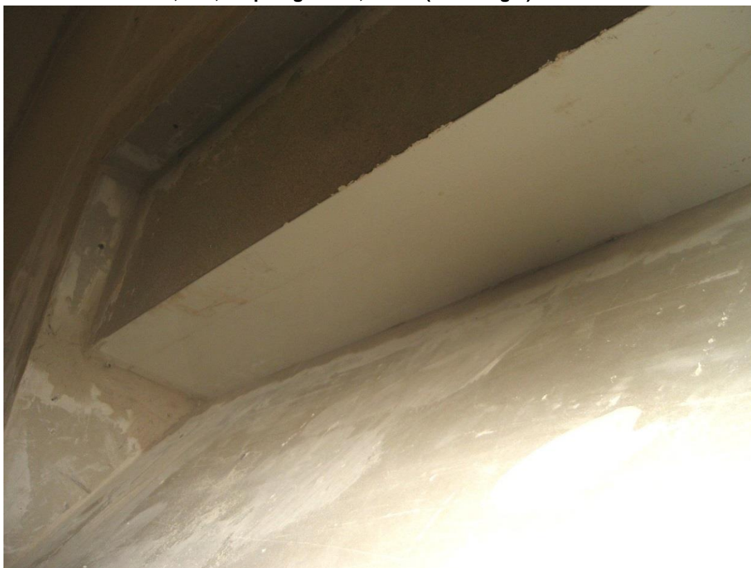
Bild 4: ROKA - TOP 2 36,5/30, Empfangsraum, Detail (Messung 3)
